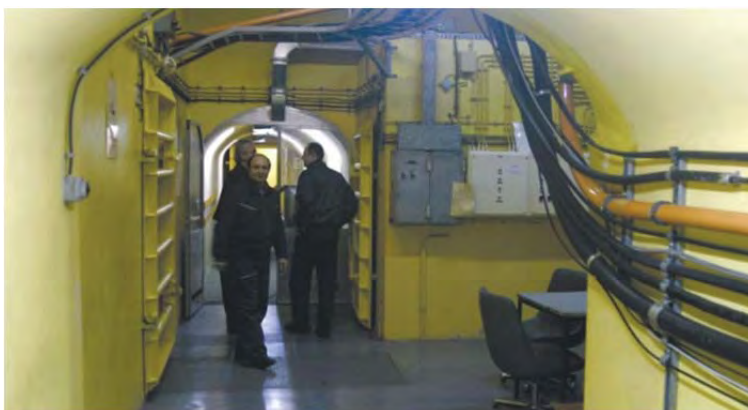
Hodnik in inštalacije zaklonišča (Vir: Google, slike)
